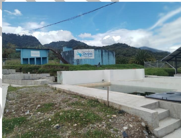
Fotografía 11. Infraestructura de Agua entubada
