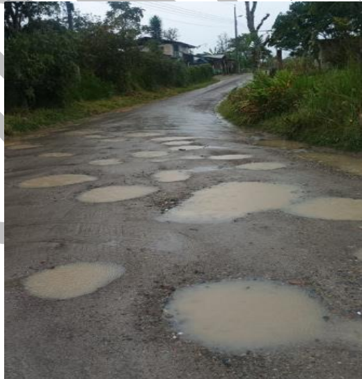
Fotografía 6. Estado vial, tramos de la vía Campo Libre-Bypass
